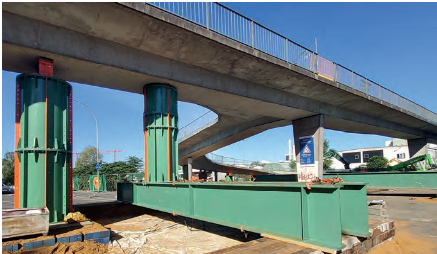
Hilfsstütze: Als Hilfskonstruktion bis zu einer Höhe von 4,50 m wurden Tonnenstützen eingesetzt. Um den Kanal vor zu hohen Belastungen zu schützen, wurden Joche zur Lastverteilung bzw. -überbrückung eingesetzt.
