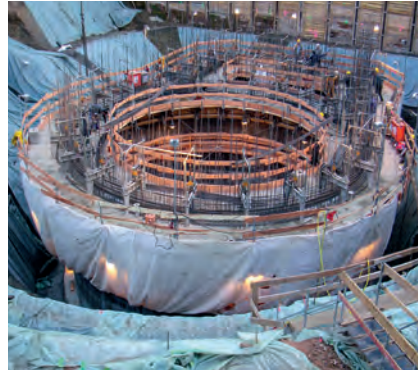
Rechenzentrum RIO - Kältespeicher
