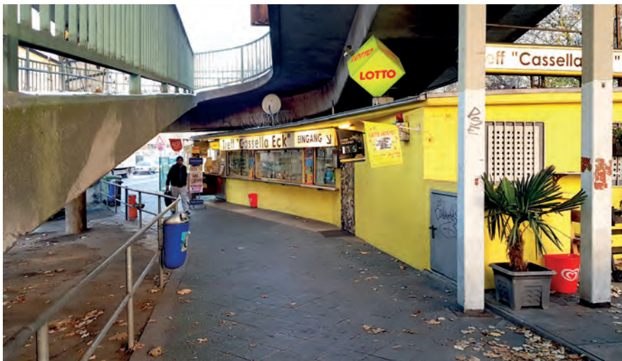
Kiosk Cassella Eck: Mit minimalem Abstand führt die Rampe zur Cassellabrücke über das Kiosk und eine Stütze der Rampe ist in das Kiosk integriert. Während des Rückbaus war der Kioskbetrieb eingestellt. Ohne jegliche Beschädigung des Kiosks wurden Brücke und Rampe zurückgebaut.
