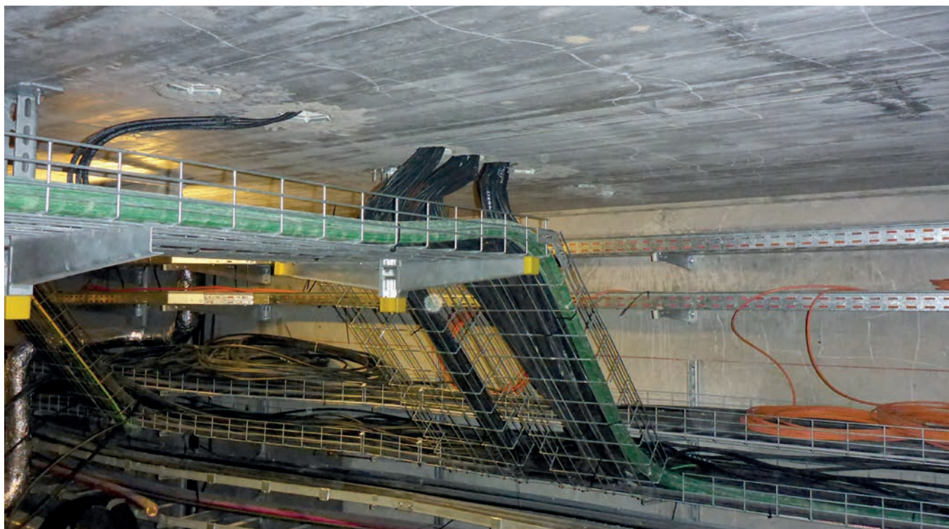
Hauptkabelführung unter dem Bahnsteig
